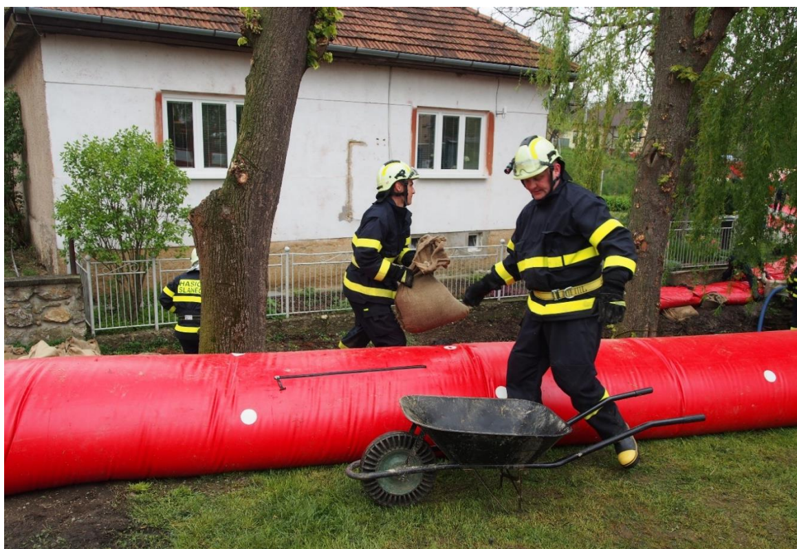
Stavanie protipovodňových bariér
